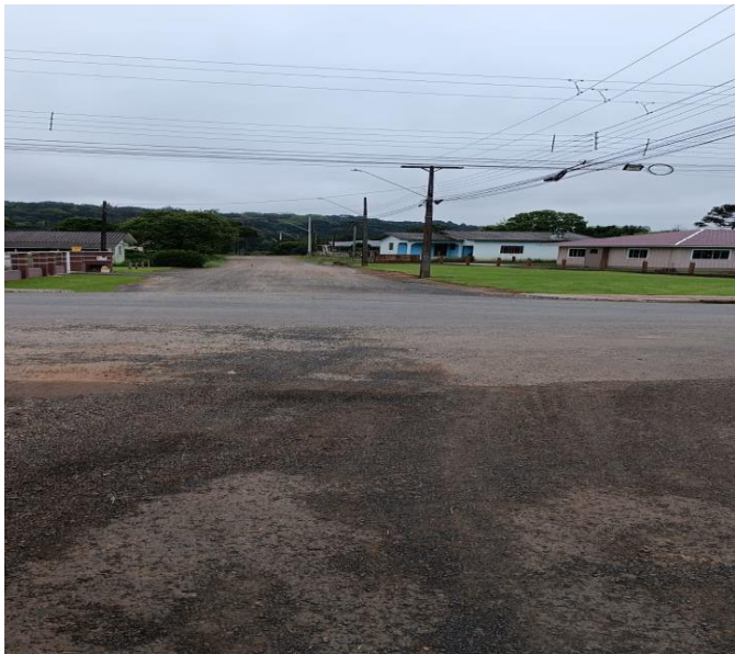
TRECHO 05: RUA ARISTO RAZERA, entre a rua Alexandre Popia e a rua Antonio Zalenc.
