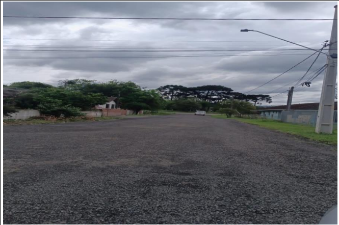
TRECHO 04: RUA JOÃO TREUCK, entre a rua Rui Barbosa e o fim da rua.
